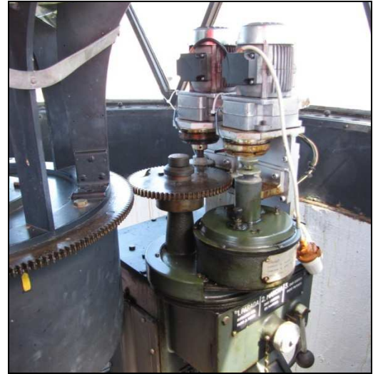
Sistema con motor eléctrico
